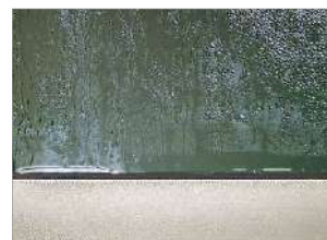
全面に大粒な結露が発生
