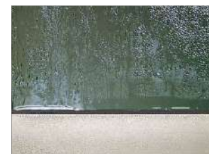
全面に大粒な結露が発生
