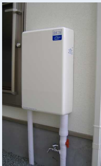
屋外の外壁に取付
