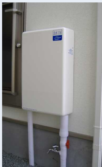
屋外の外壁に取付
