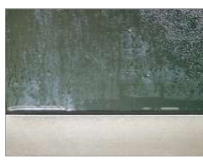
全面に大粒な結露が発生
