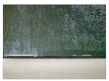
全面に大粒な結露が発生
