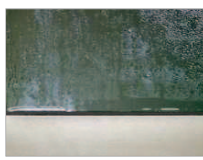
全面に大粒な結露が発生
