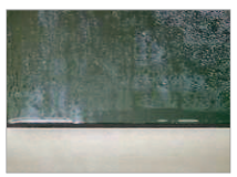
全面に大粒な結露が発生
